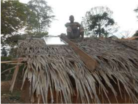
Photo: installation du kit solaire dans un ménage
